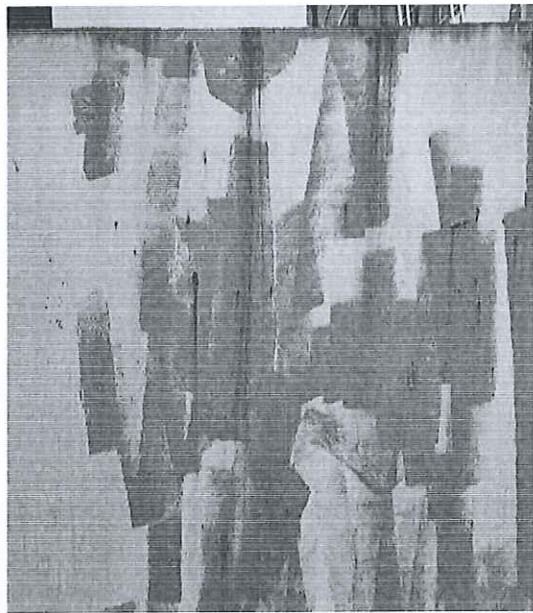
一体化水箱受锈蚀情况
